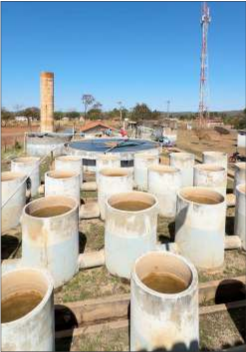
Prefeitura mantém uma Estação de Tratamento de Água
